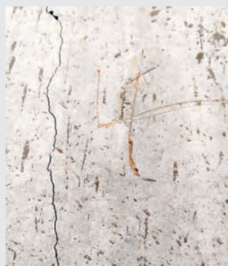
Fiche 12.03 Expertise d'un réservoir fissuré
