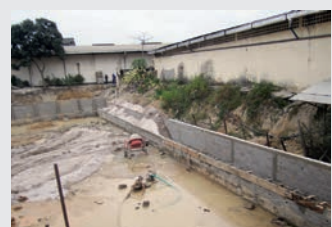
Fiche 2.06 Désordres liés aux travaux de voisinage
