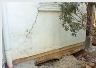
Fiche 2.05 Désordres au niveau des fondations
