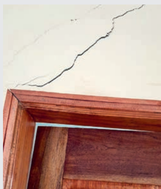
Fiche 12.02 Expertise de bâtiments fissurés
