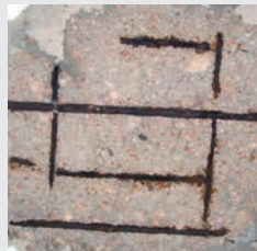
Fiche 1.06 Corrosion de l'acier
