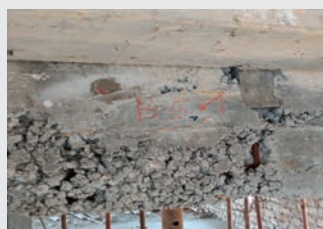
Fiche 4.03 Dégradations et désordres dus aux défauts d'exécution
