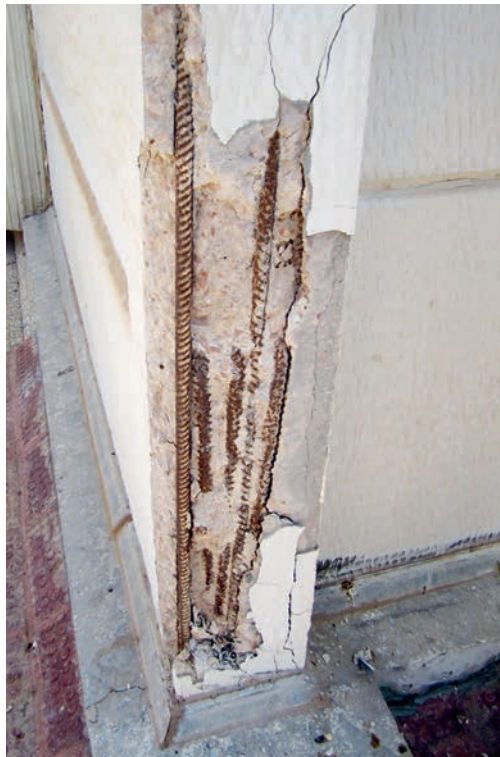
Photo 1.01-1. Corrosion des armatures et éclatement du béton d'enrobage causés par la carbonatation du béton
