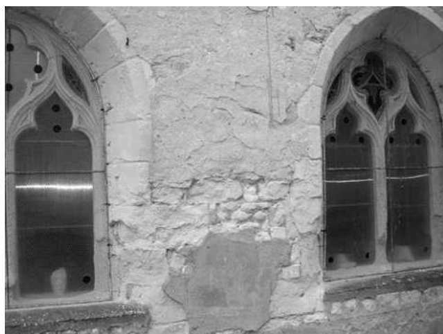
Photo 1.7. Attaque du calcin sur un calcaire tendre aggravé par un enduit hydraulique
