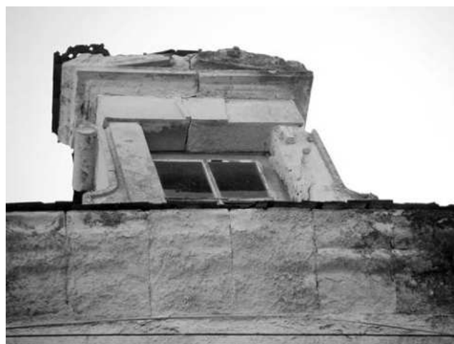
Photo 1.8. Dégradation de la corniche et du jambage d'une lucarne faute d'entretien
