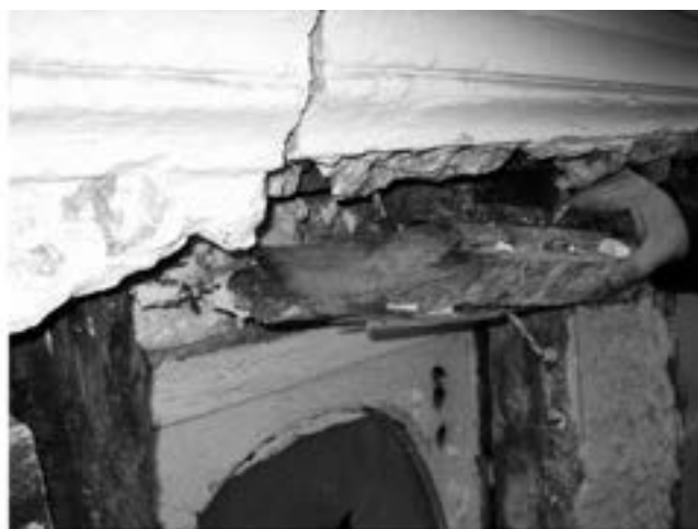
Pièce de bois détruite
