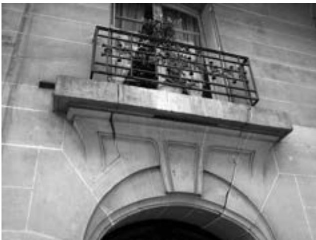
Photo 8.10. Élément disjoint à consolider par brochage
